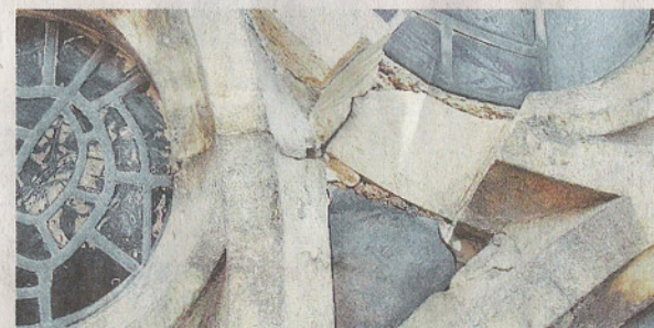
Die Maßwerke der Fenster waren in einem maroden Zustand. Inzwischen sind sie restauriert worden. FOTO: KN
